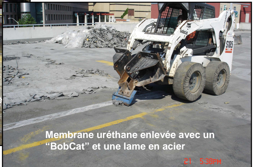
Greensolv 273M est couvert pendant 24hres après avoir été appliqué sur une membrane de goudron de houille époxydique
